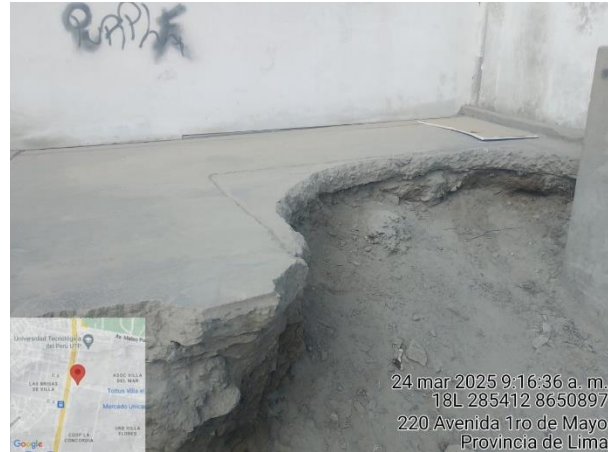
Figura 01. Situación actual del pozo según VTC.
